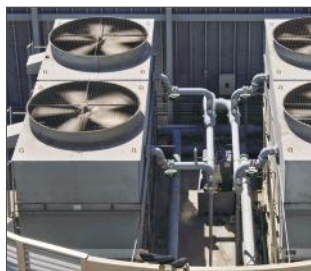
FAN AND PUMP
